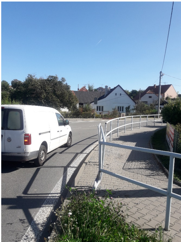
Obrázek 1 Poškozené zábradlí, křiž. ulic Pod Hradbami-Jihlavská-kpt. Jaroše
