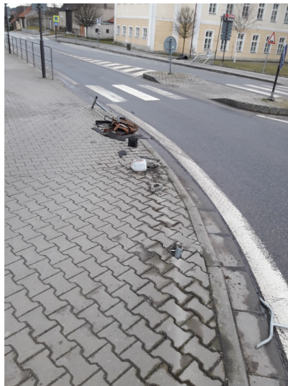
Obrázek 2 Poškozené zábradlí, ul. Na Valech
