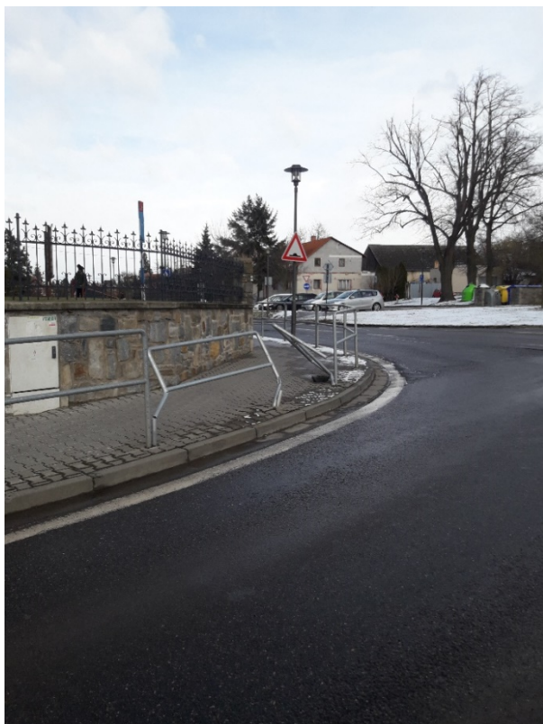
Obrázek 3 Poškozené zábradlí, ul. Tišnovská
